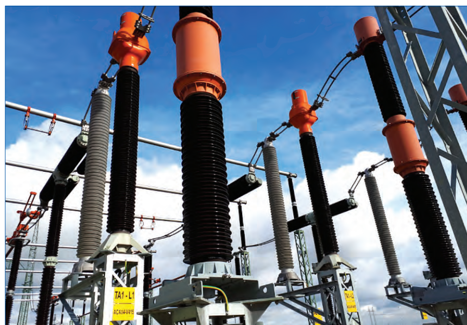
Obr. 11: Proudové a napěťové transformátory
