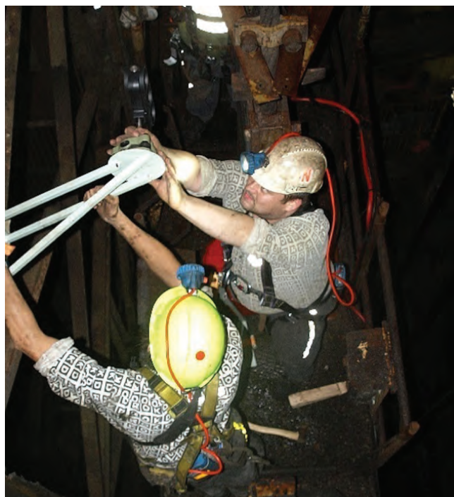
Obr. 2: Připojovací měření pro sledování vodorovných pohybů v jámě Zdroj: OKD
