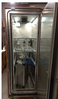
Obrázek 1: Detail vnitřního uspořádání komory s instalovanými etalony odporu a impedance
